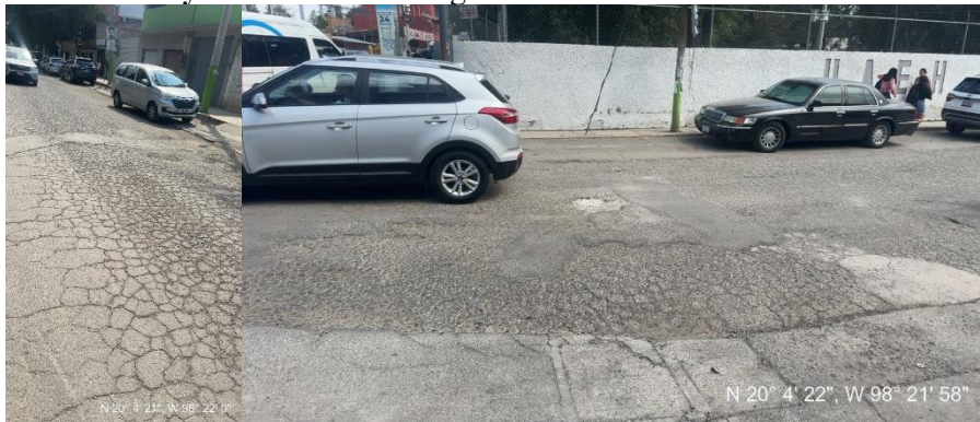
FIGURAS 6 y 7.- Evidencias fotográficas de las afectaciones encontradas en la zona de estudio
